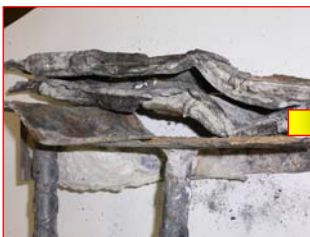
凍結防止剤散布による伸縮装置の腐食
