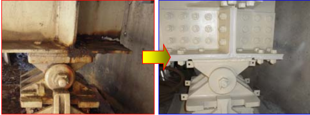
ウェブの貫通腐食
