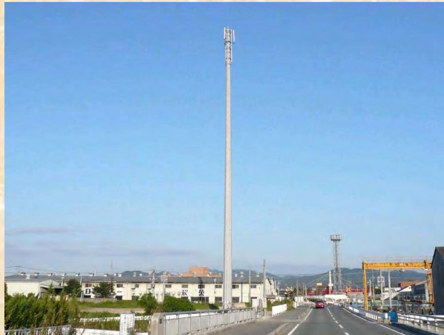
携帯電話用のアンテナ塔
